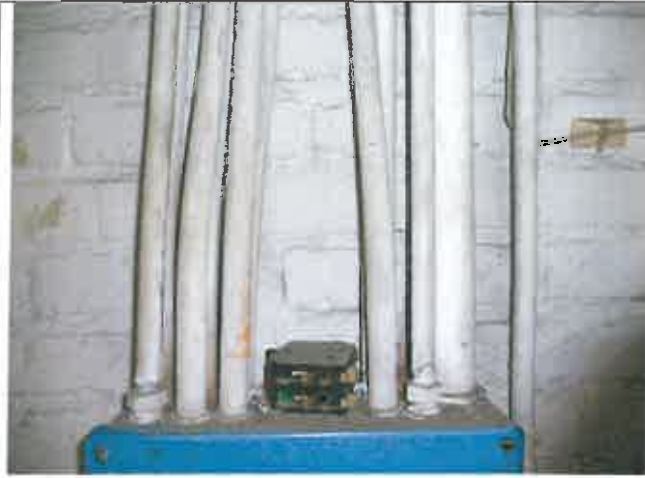
Rd. 21-22, Room 01 Conduit
