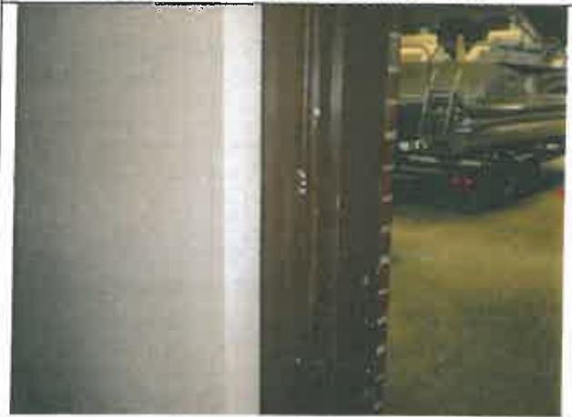
Photo #3: Brown door frame – LBP.
